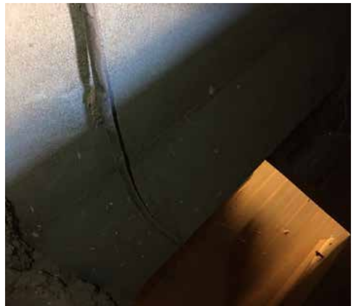
Comprobación del estado del recubrimiento Devcon Dfense Blok después de 1 año de operación. Se aprecia mínimo desgaste.
