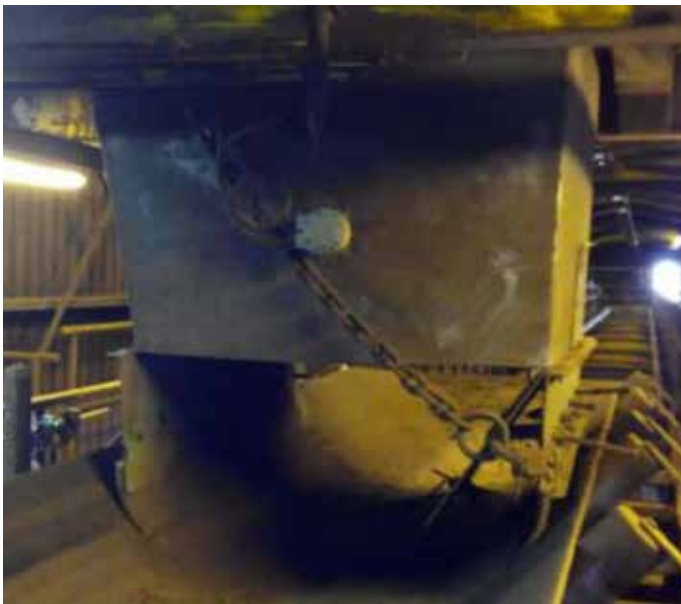
Tolva de caída de biomasa a silo.
