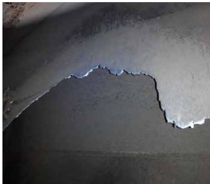
Comprobación de la chapa soldada como protección después de 4 meses de operación. Se aprecian importantes signos de desgaste.
