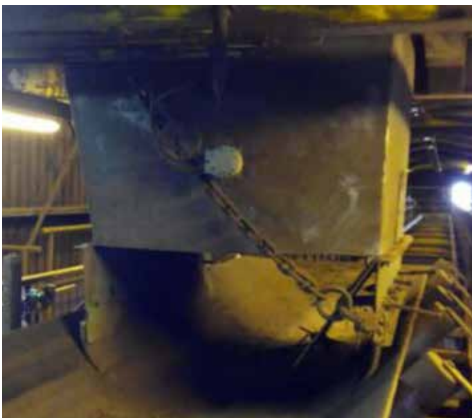
Tolva de caída de biomasa a silo.
