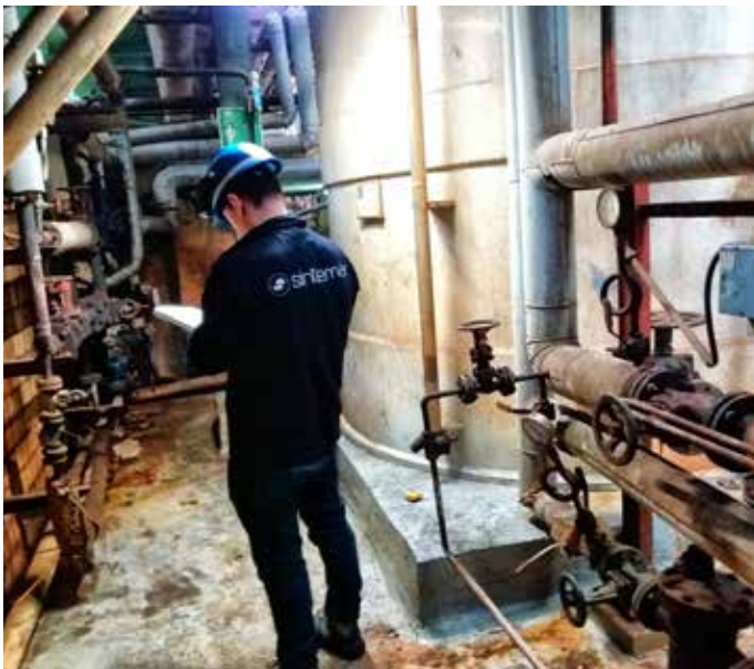
Estado inicial del cubeto de contención con ácido clorhídrico y estudio de la situación por parte del técnico de SINTEMAR.
