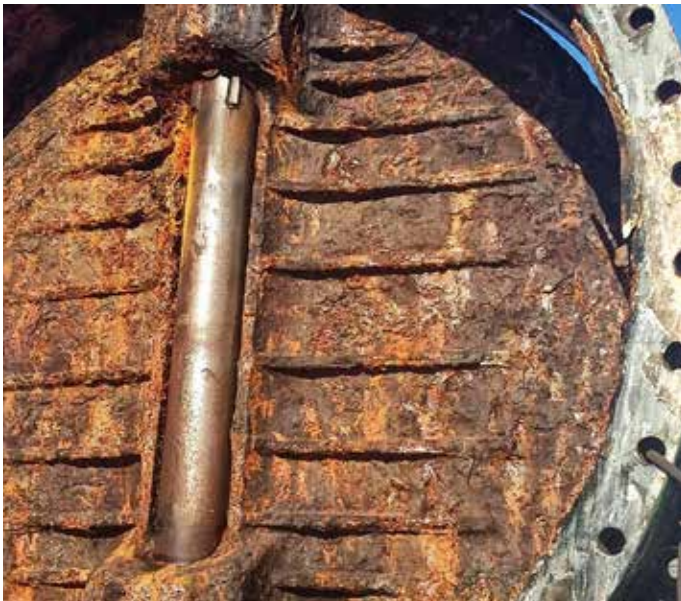
Estado inicial de la válvula con daños por corrosión y erosión.
