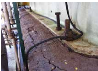
Detalle de grietas en grout cementoso.
