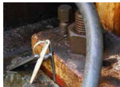
Detalle de holgura en grout cementoso.
