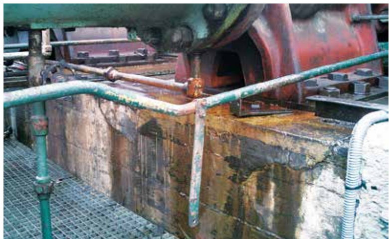
Contaminación y grietas en el grout.
