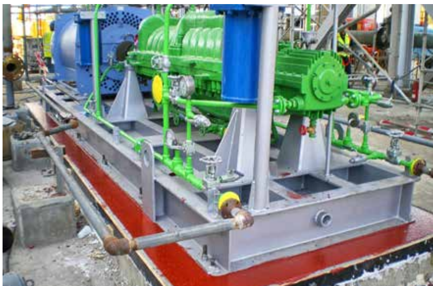
Grouting de motor y bomba multietapa.
