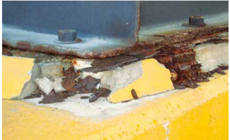
Rotura del grout cementoso por oxidación de placas.
