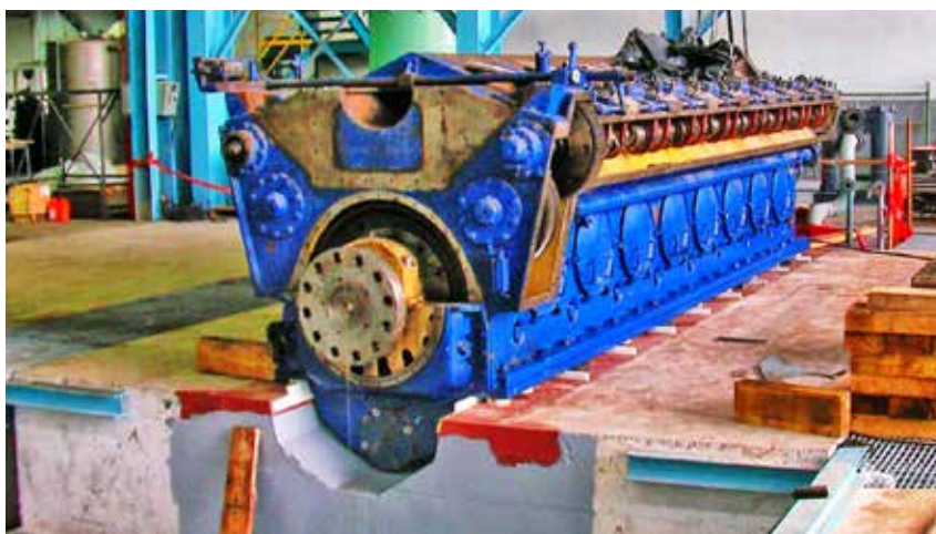
Motor sobre pregrouting de Chockfast Rojo.
