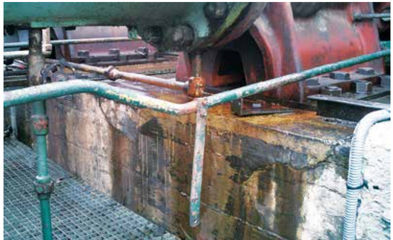
Contaminación y grietas en el grout.
