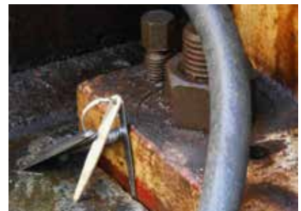
Detalle de holgura en grout cementoso.
