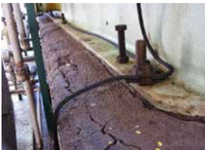
Detalle de grietas en grout cementoso.
