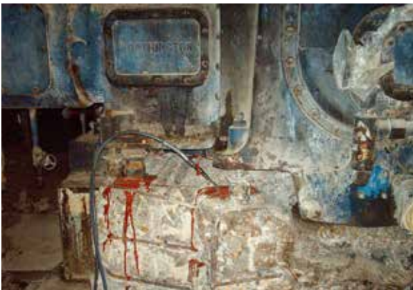
INYECCIÓN EN HORMIGÓN, Inyección de resina epoxi a presión para reparar grietas.
