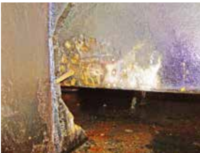
Perforación a reparar dentro del tanque de combustible. (Antes)
