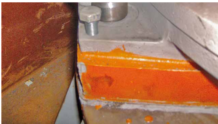
Detalle del taqueado del Servomotor con Chockfast Naranja.
