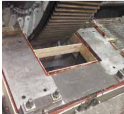
Rehabilitación de las cimentaciones de apoyo de los piñones de 6 molinos con la resina epoxi Chockfast Rojo . Mina "Buenavista del Cobre", Cananea, México.
