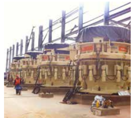
Fijación de 14 trituradoras con la resina epoxi Chockfast Rojo . Proyecto de ampliación de la mina "Buenavista del Cobre", Cananea, México.
