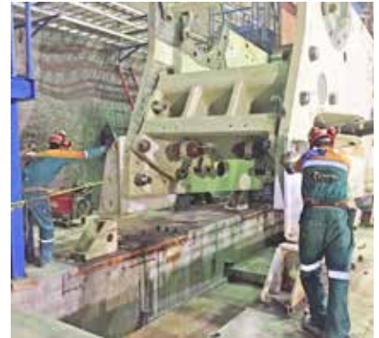
Grouting de los equipos de trituración y sus motores con resina epoxi Chockfast Rojo y Chockfast Naranja . Unidad "Tayahua", Zacatecas, México.
