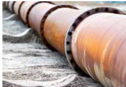
Conducciones corroídas bajo tierra.
