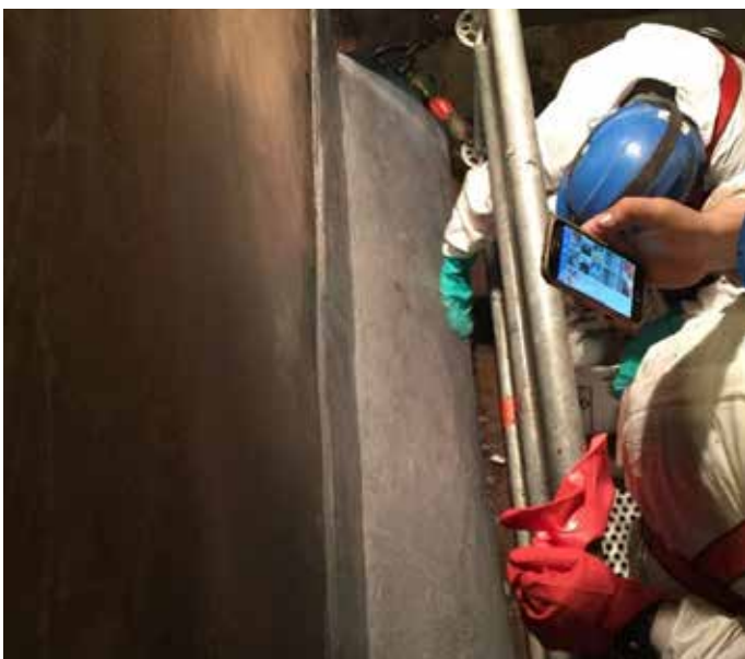
Aplicación del recubrimiento de protección Devcon Dfense Blok, sin necesidad de soldadura.
