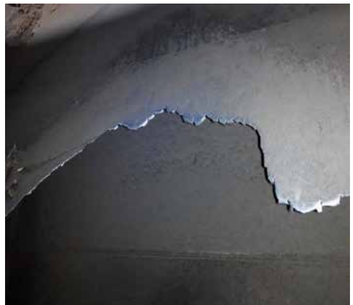
Comprobación de la chapa soldada como protección después de 4 meses de operación. Se aprecian importantes signos de desgaste.
