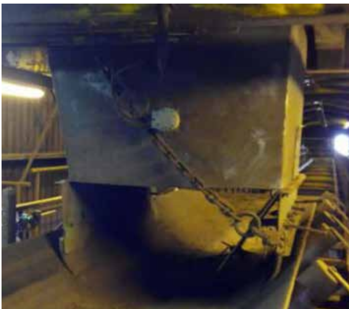
Tolva de caída de biomasa a silo.
