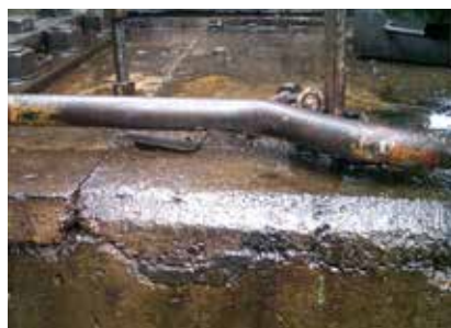
Grout cementoso contaminado y separado de la cimentación.
