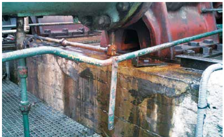
Contaminación y grietas en el grout.
