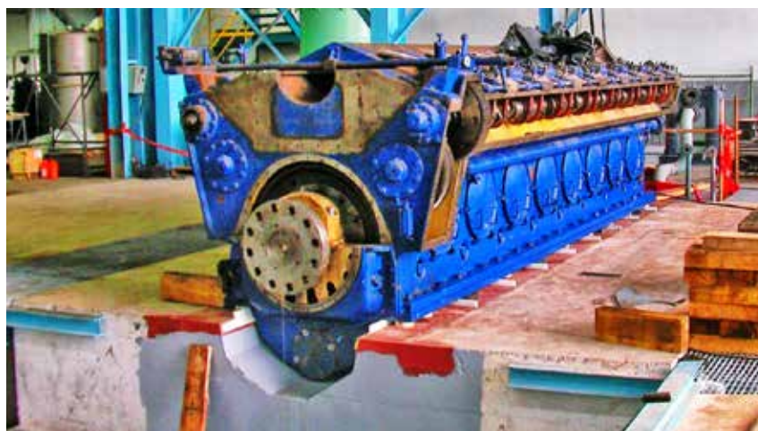
Motor sobre grouting de Chockfast Rojo.
