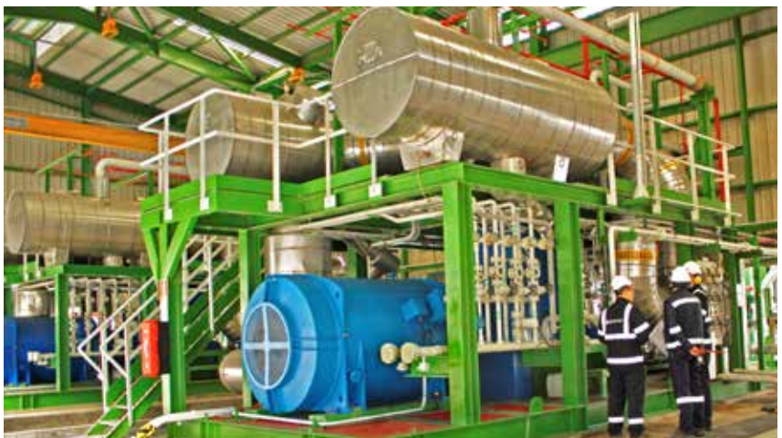
Inspección de compresor alternativo instalado con Chockfast Rojo.
