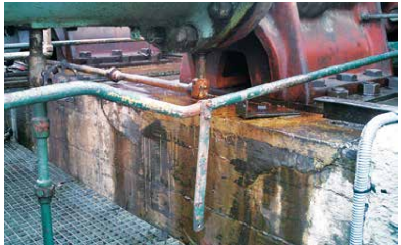
Contaminación y grietas en el grout.
