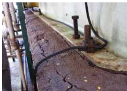
Detalle de grietas en grout cementoso.
