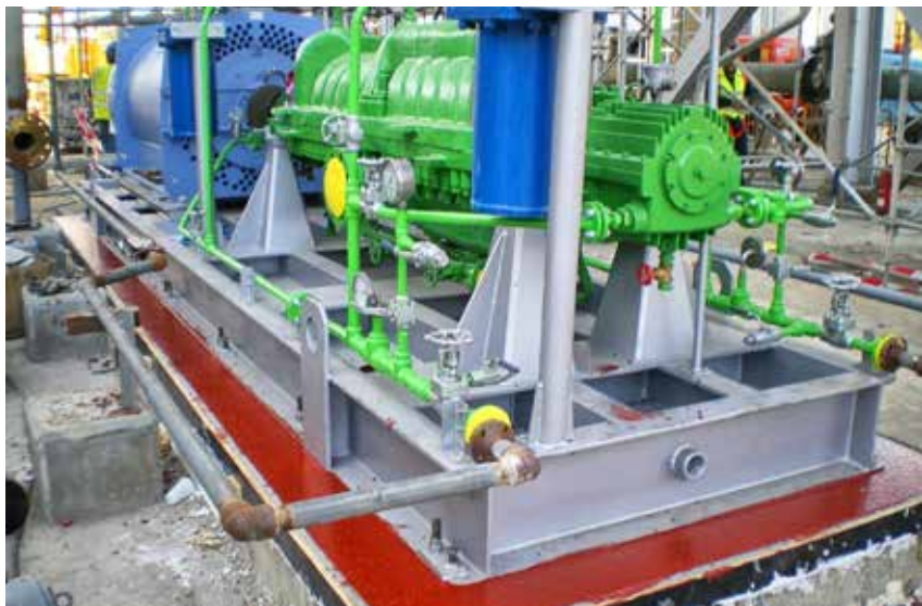
Grouting de motor y bomba multietapa.
